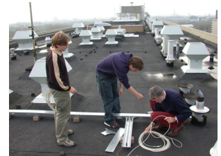
Kabels leggen voor aansluiting van de detector op de apparatuur voor registratie en verwerking.
